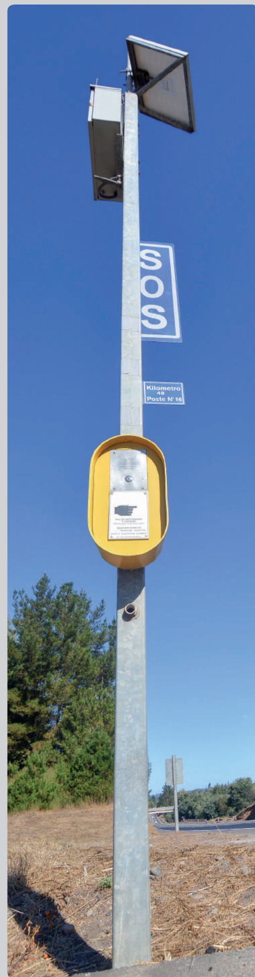
Poste Servicio Atención Emergencia / Emergency Assistance Pole
